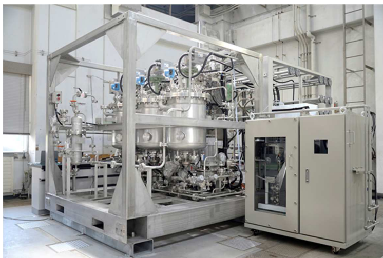
図1 実用化に向けて開発が進められているiFactory®のモジュール（左）と自動分析装置（右）
