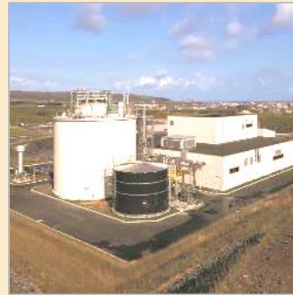
▶ バイオガスシステム
