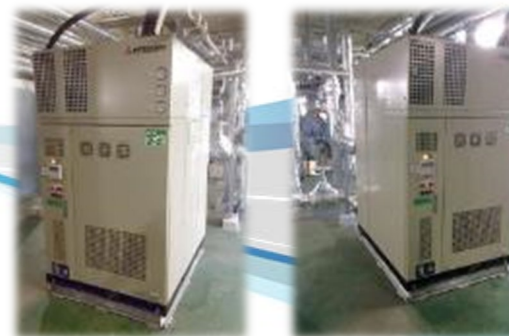
■ 消化槽の熱回収（ヒートポンプ）
