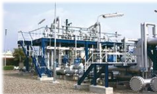
■ 液ガス熱調設備
