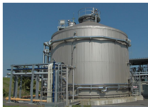
無動力消化槽
