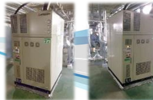
■ 消化槽の熱回収（ヒートポンプ）
