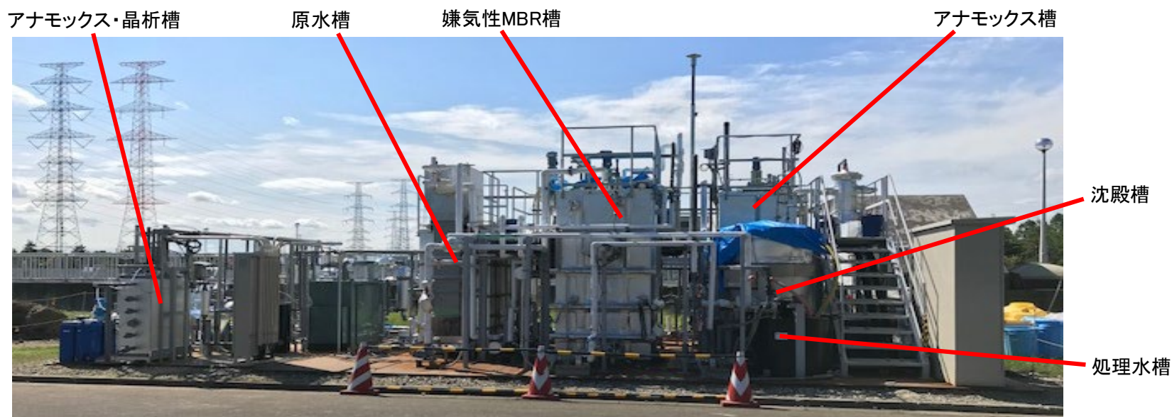
宮城県仙塩浄化センター実証プラント
