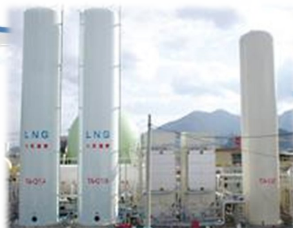
■ LNG (液化天然ガス) サテライト設備
