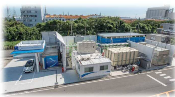
■ 水素ステーション
