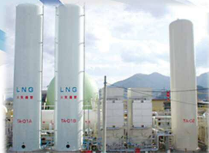
■ LNG(液化天然ガス)サテライト設備
