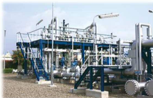
■ 液ガス熱調設備
