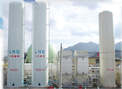
■ LNG(液化天然ガス)サテライト設備
