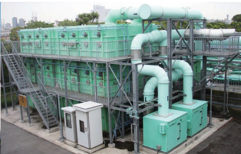
生物脱臭装置
