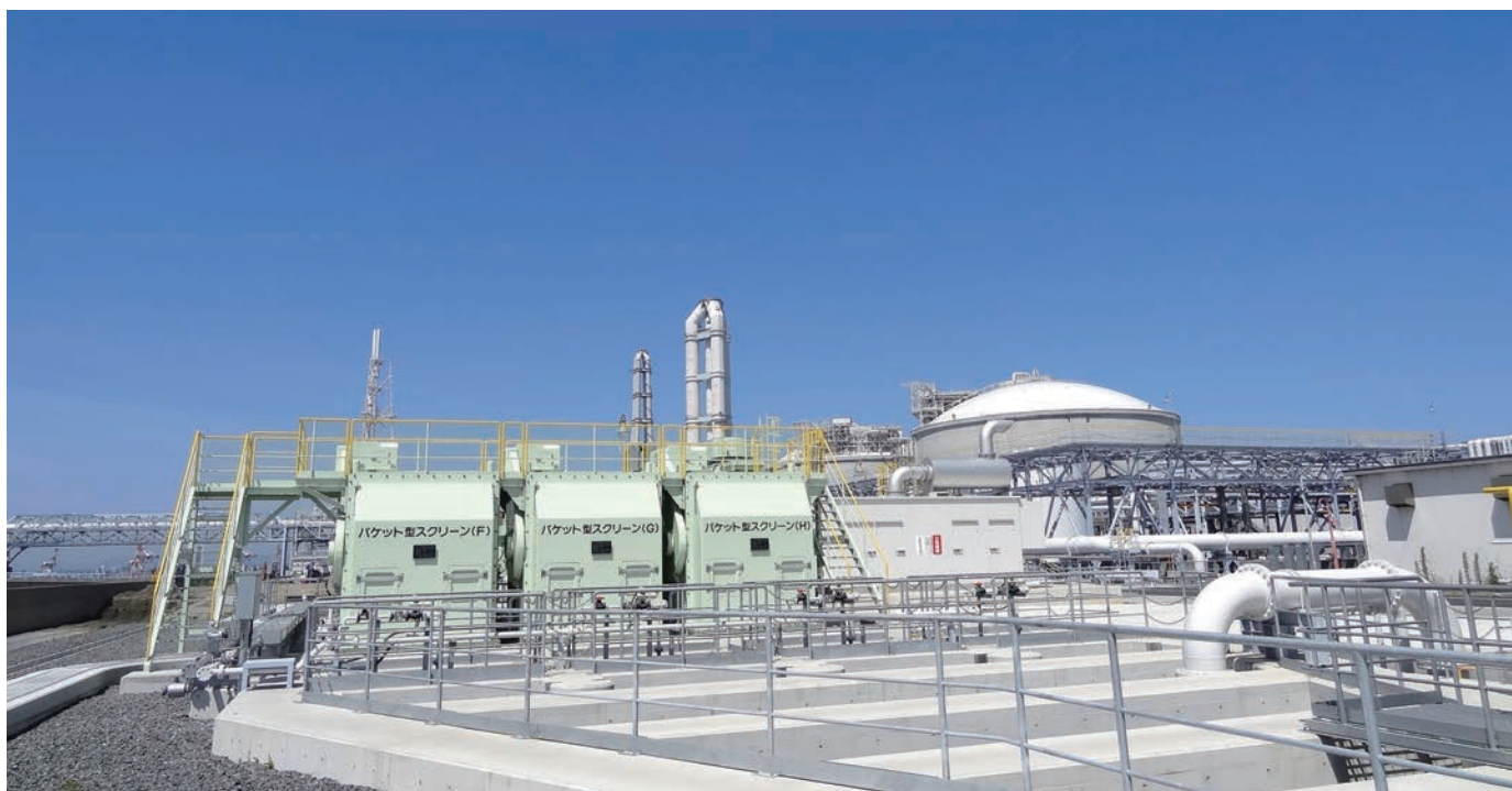
LNG基地向 納入スクリーン設備
